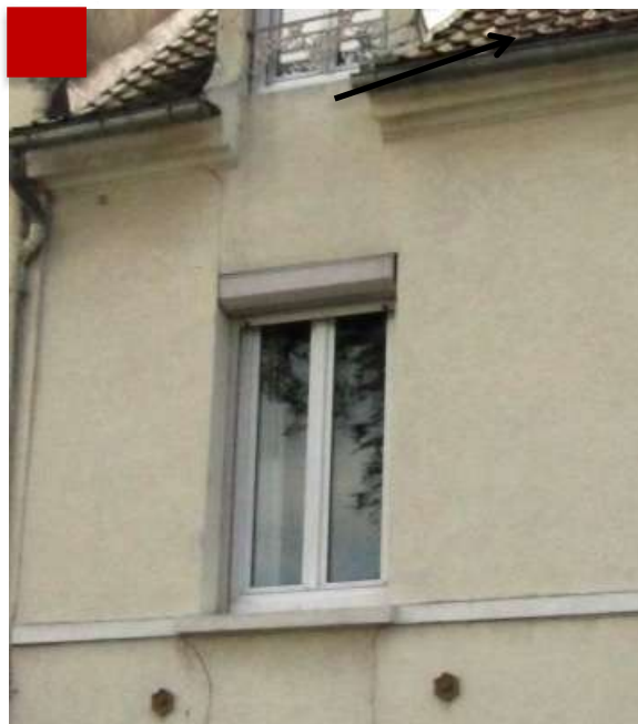
A proscrire : volets roulants avec coffret visible en façade sur rue
