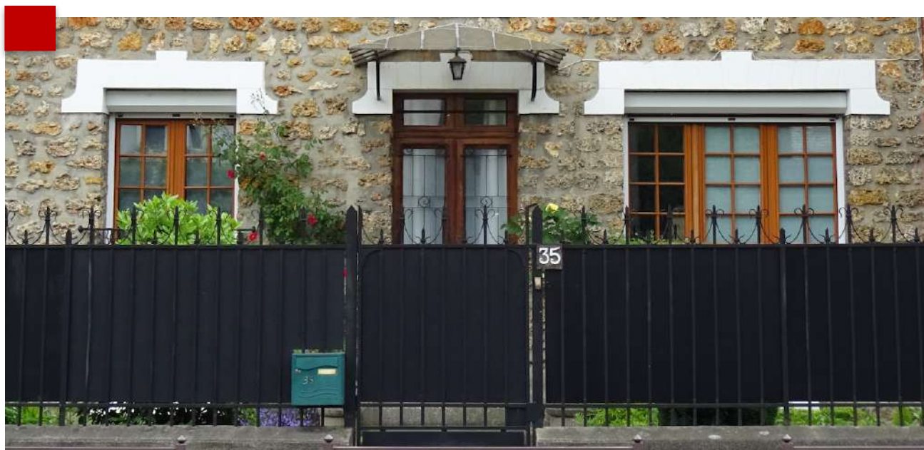
A éviter : découpage des vantaux en carreaux trop petits et trop nombreux et couleur non harmonieuse avec la construction, volets roulants, caissons de volets roulants et leurs coulisses en aluminium
