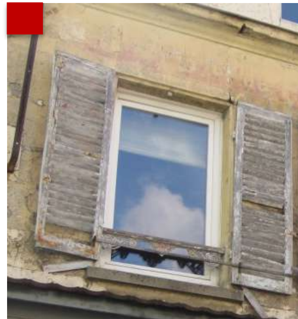
A éviter : les menuiseries de fenêtre en PVC
