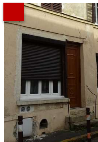
A éviter : exemple d'ancien commerce transformé en habitation sans recomposition de la façade
